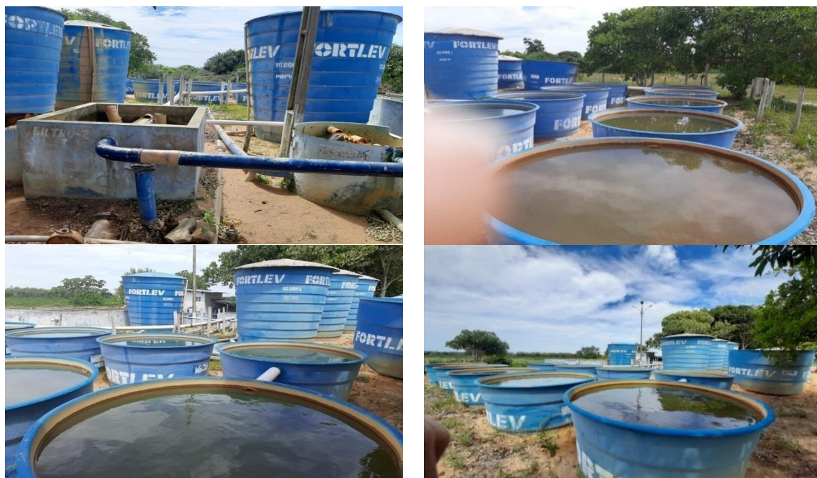
Figura 8 – Imagens da Estação de Tratamento de Água.
