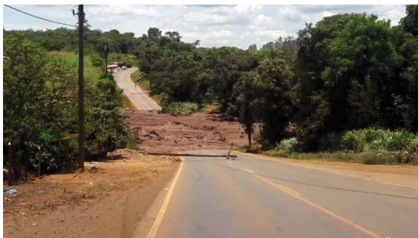
Figura 2 - Estrada de ligação entre interior e sede de Brumadinho interditada. Fotos tiradas no dia 25/01/2019. Créditos: Marciano Reis Mariano.
